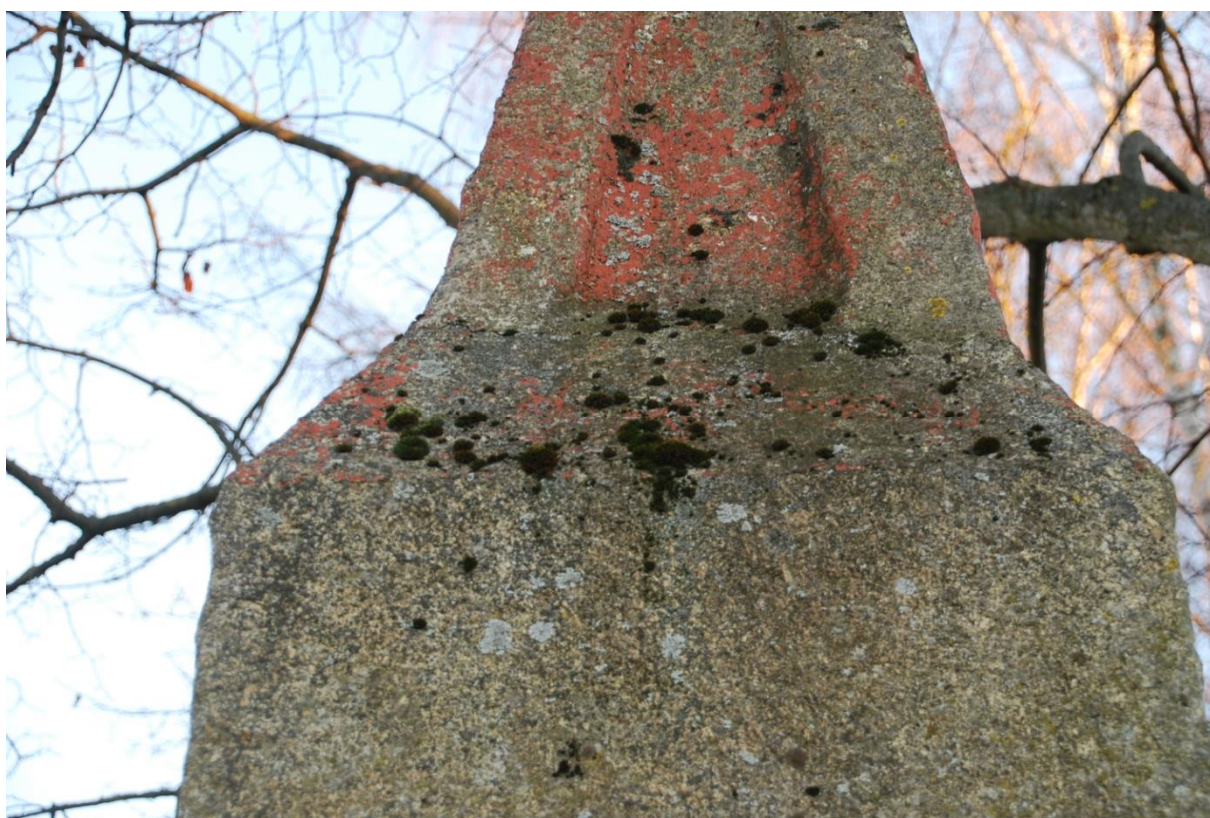
Detailní pohled na boflí muka. Pohled na stíku s biocidním napadením (mechy, lišejníky a algy) a na souvrství s jifl dofilou červenou povrchovou úpravou na cementové krustě. Souasný stav památky před restaurováním.
