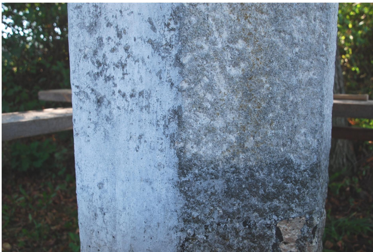
Průběh restaurování. Snímání nevhodných cementových malt a pletiva. Detailní pohled na dík.
